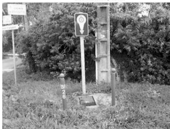
Photo de l'hydrant
