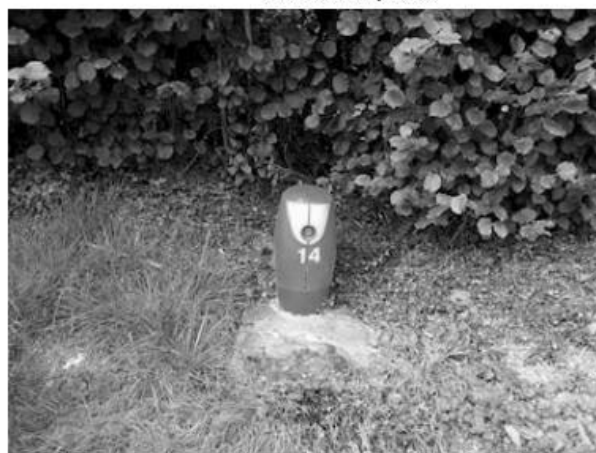
Photo de l'hydrant
