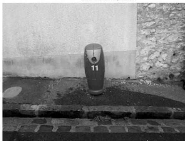
Photo de l'hydrant
