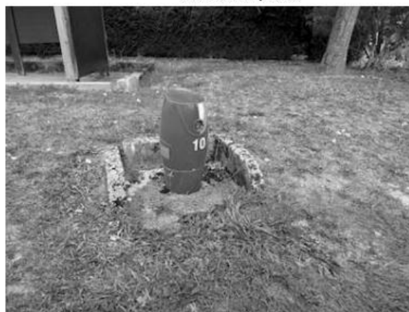
Photo de l'hydrant
