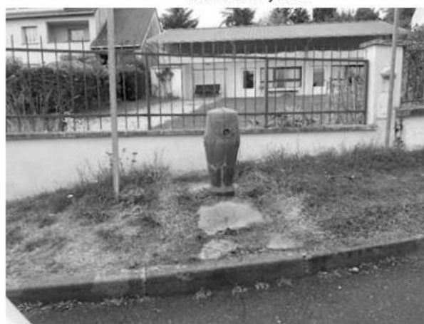
Photo de l'hydrant
