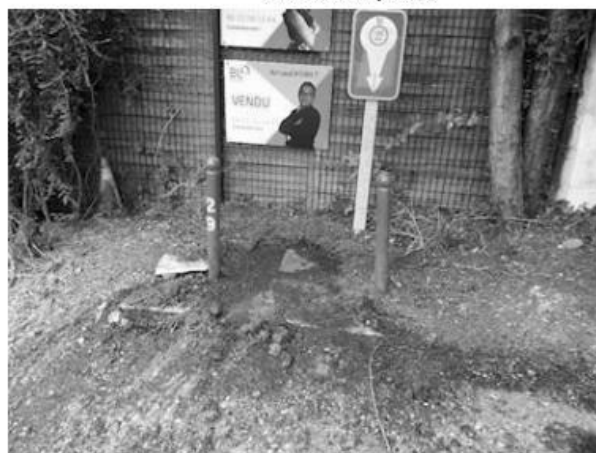
Photo de l'hydrant
