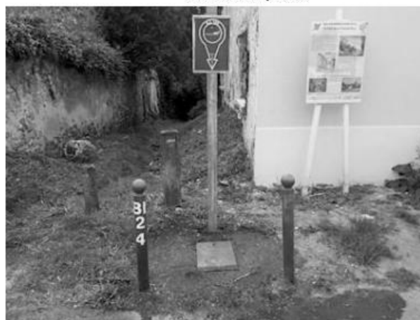
Photo de l'hydrant
