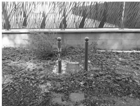
Photo de l'hydrant
