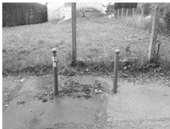
Photo de l'hydrant
