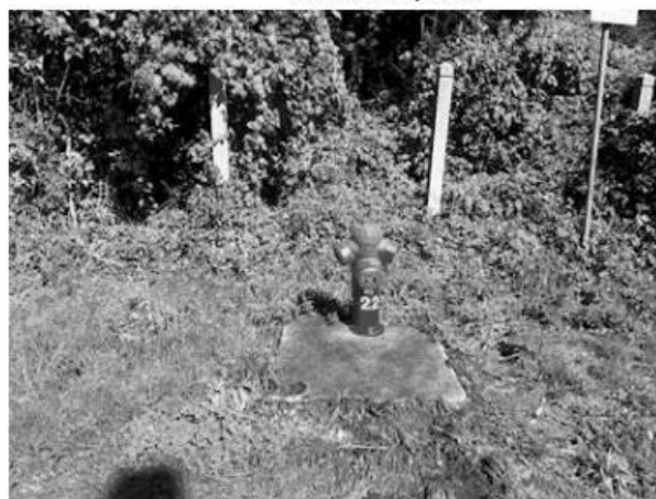
Photo de l'hydrant
