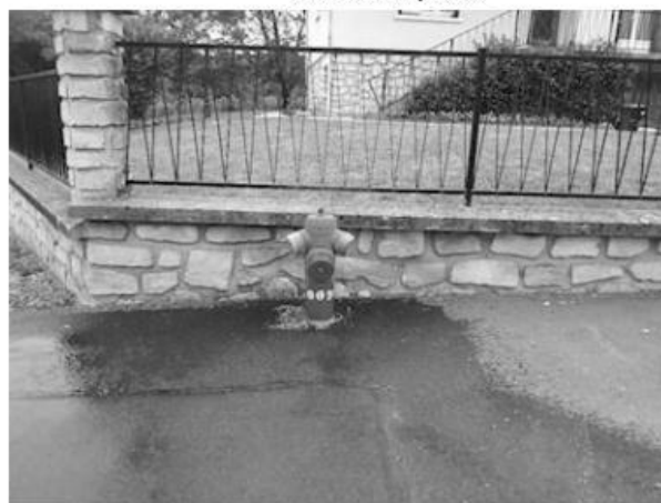
Photo de l'hydrant
