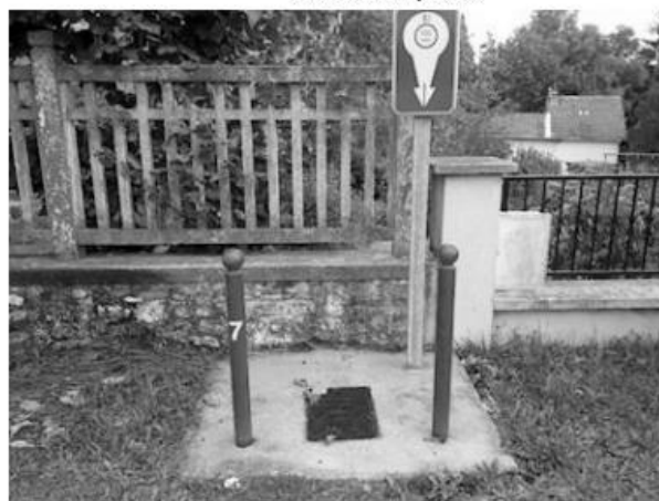
Photo de l'hydrant
