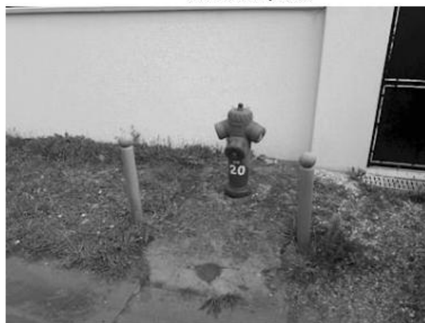
Photo de l'hydrant
