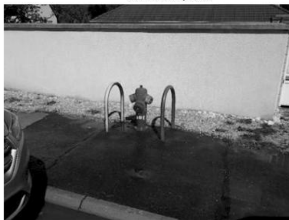
Photo de l'hydrant
