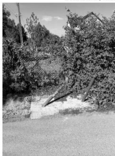
Photo de l'hydrant
