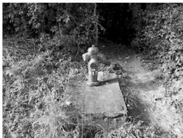
Photo de l'hydrant
