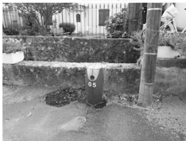
Photo de l'hydrant
