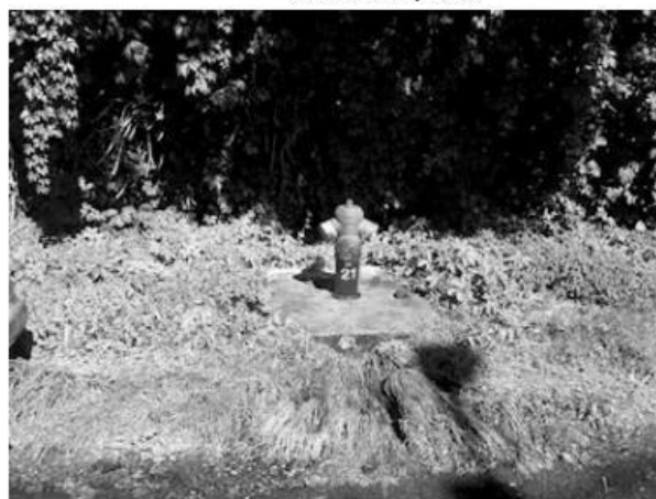
Photo de l'hydrant
