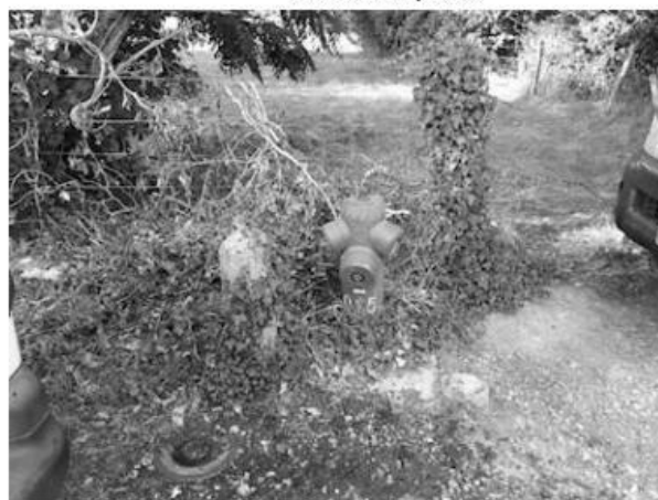
Photo de l'hydrant
