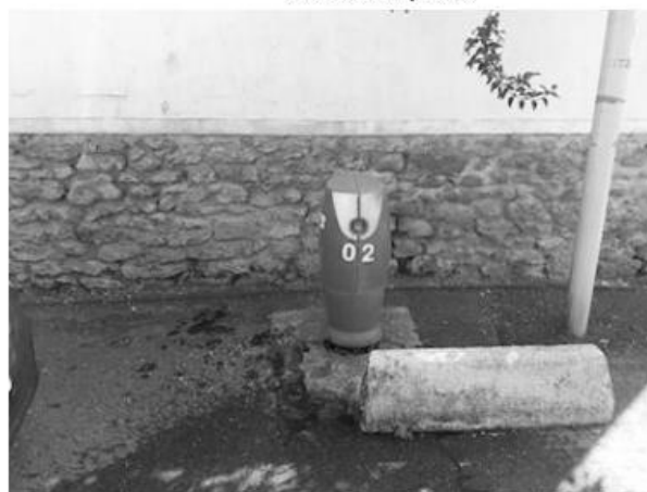
Photo de l'hydrant
