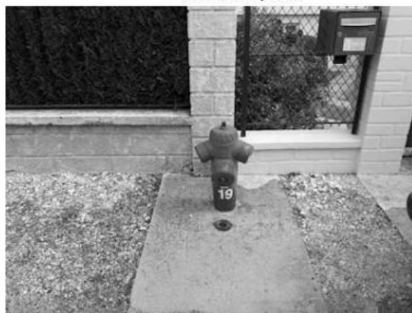
Photo de l'hydrant
